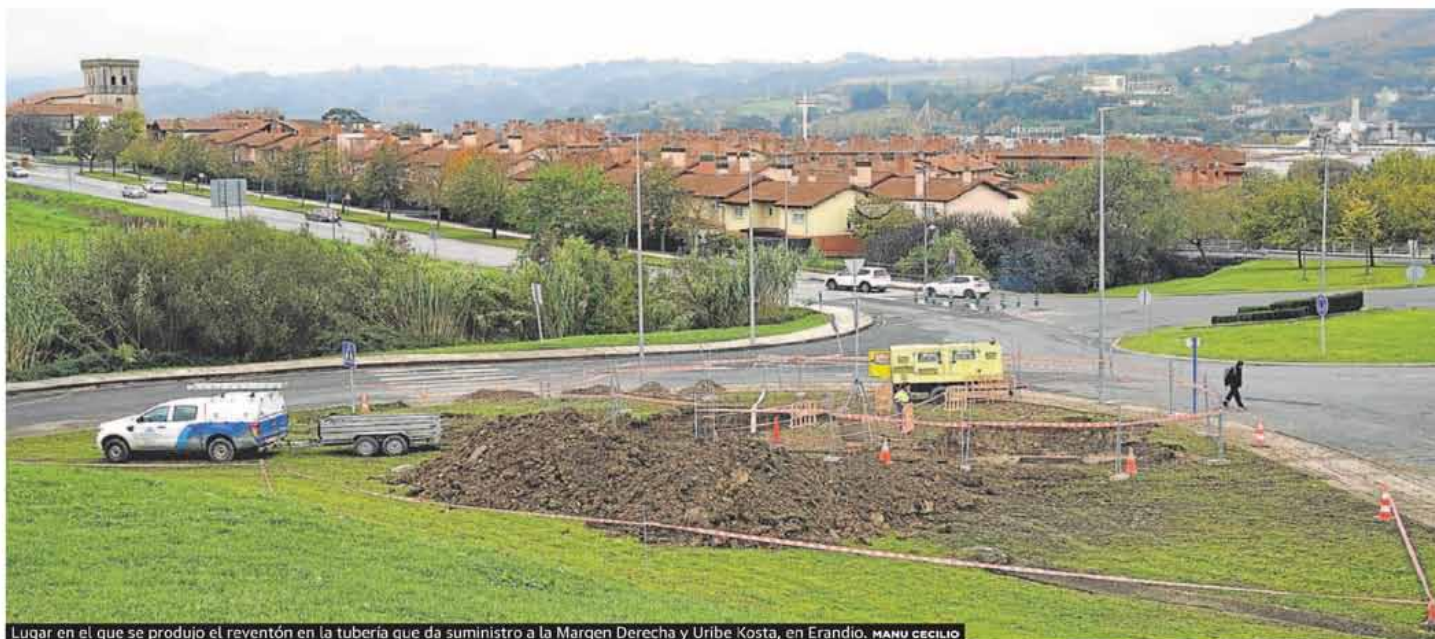
Lugar en el que se produjo el reventón en la tubería que da suministro a la Margen Derecha y Uribe Kosta, en Erandio. MANU CECILIO
